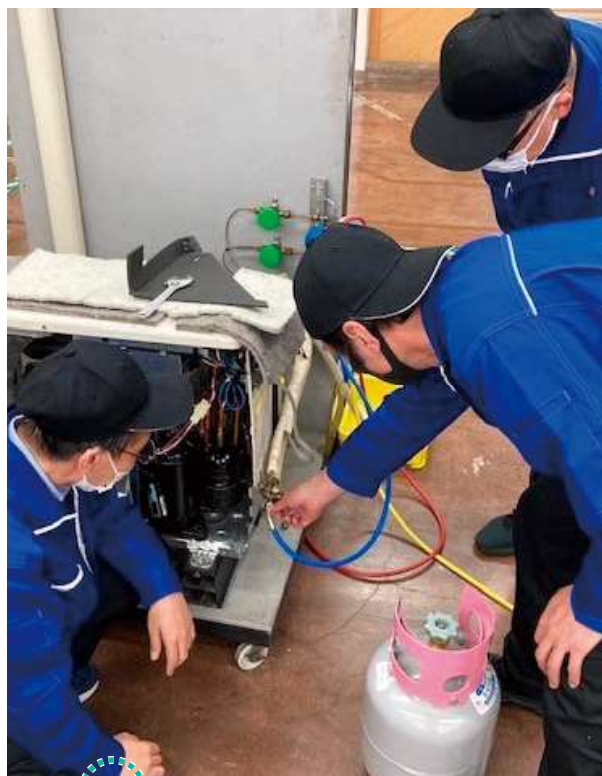
家庭用エアコン点検等実習
