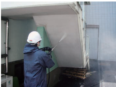
建築塗装実習（高圧水洗浄） 外壁を高圧水洗浄機で清掃しています。
