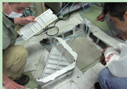
床配線の確認
