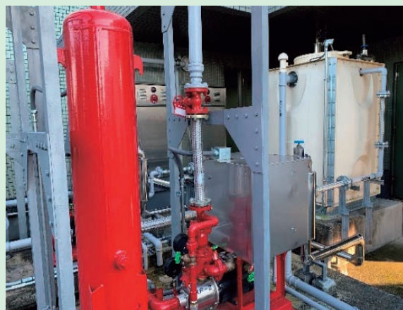
消火栓・スプリンクラー実習設備
