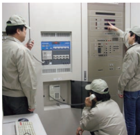
実習の様子(防災センター業務)
